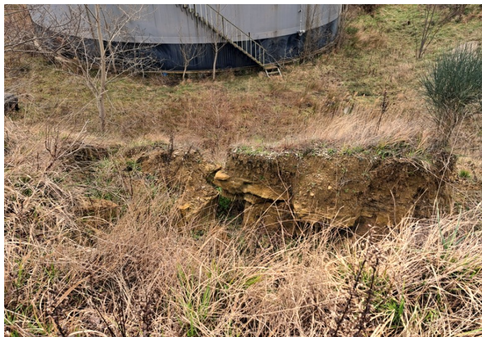
Frana presso sentiero di accesso TK 33
